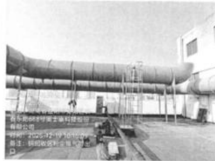
A 2 铜回收区粉尘排气筒出口 (DA087) (E: 112.352940; N: 28.610792)
