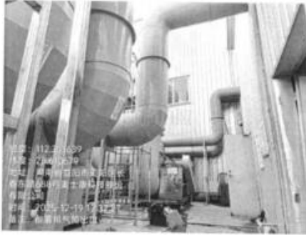
A 1 酸雾排气筒出口 (DA085) (E: 112.353639; N: 28.610679)
